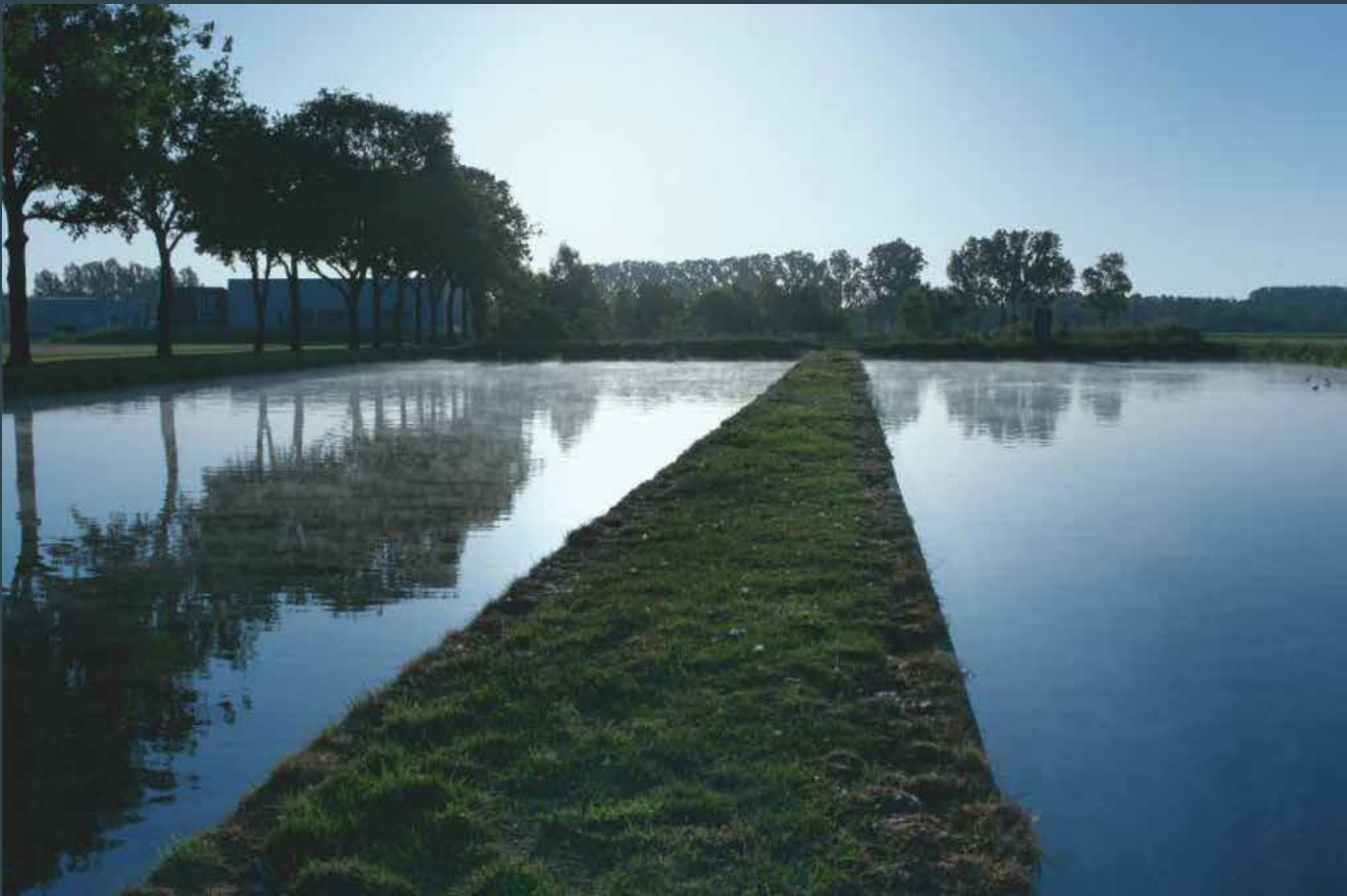
Waterzuiveringsinstallatie van Bavaria.
