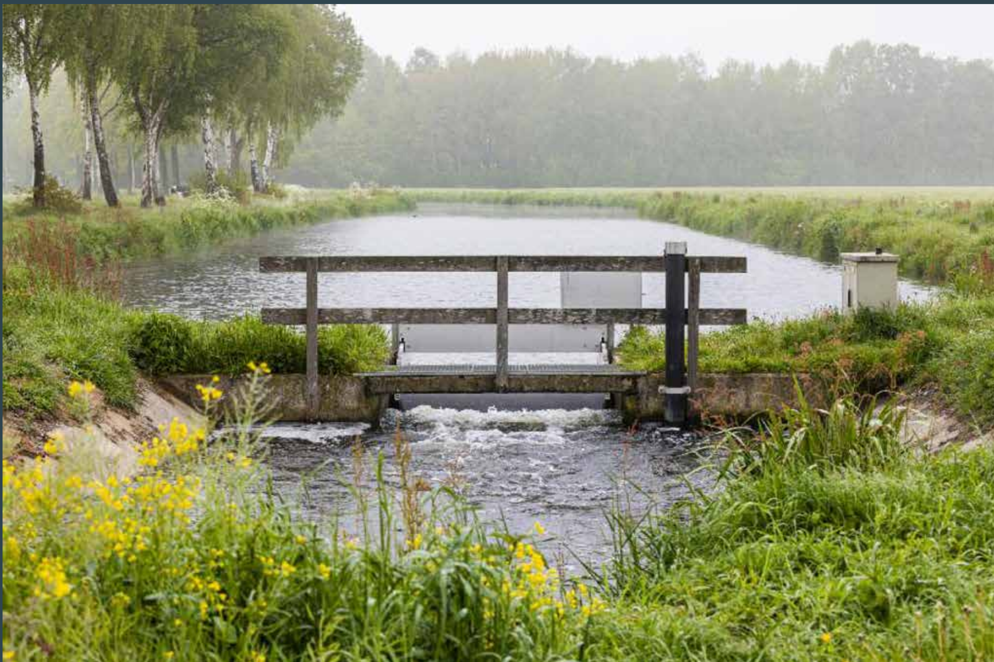
Stuw in het Boer Bier Water project.
